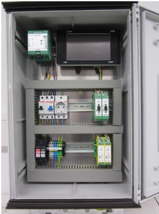
Abbildung 6: Beispiel eines Standard Lufft UMB-Schaltschrankes
